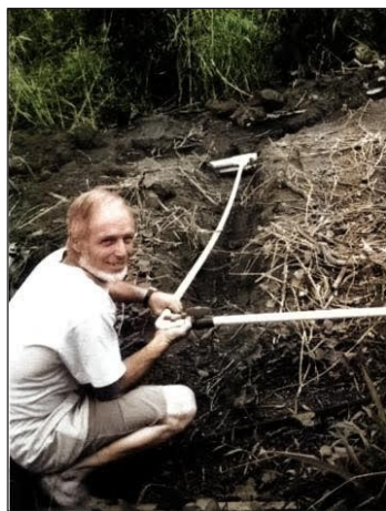
Дэвид Хосик пускает по трубам воду для каждого здания кампуса.
